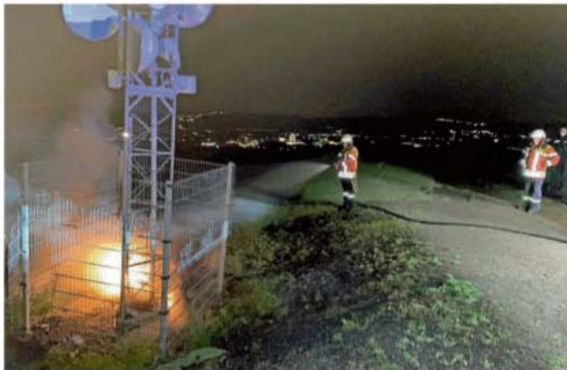
Der Steuerschrank des Sendemastes auf der Bergehalde Ensdorf wurde bei dem nächtlichen Brand zerstört.
