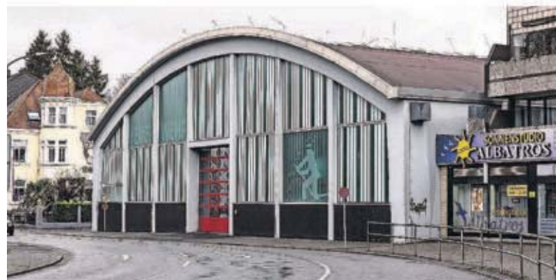
Enteisungsmaßnahmen am Dach der Feuerwache des Löschbezirks Innenstadt machen eine Sperrung der Titzstraße erforderlich.
