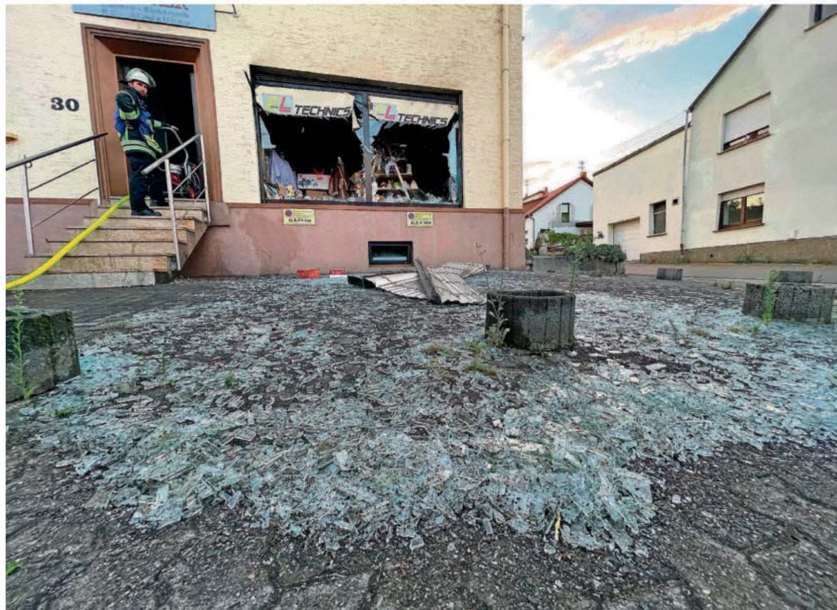
Auch für die Lebacher Feuerwehr kein alltägliches Bild: Nach einer Explosion in einem Lebacher Wohn- und Geschäftshaus am Donnerstagabend blicken die Einsatzkräfte auf ein Meer von zersplitterten Glasscherben. Die Bewohner des Hauses, ein älteres Ehepaar, kommt mit dem Schrecken davon. FOTO: BECKERBREDEL
